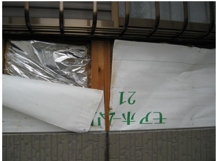
防湿シートの重なり不足と防水テープの未施工 サイディングの繋ぎ目にハットジョイナー未施工
