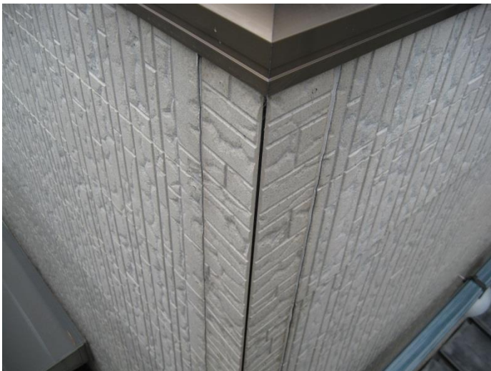
ハットジョイナー未使用のためサイディングが引っ張られベランダの出隅が開いてしまっている
